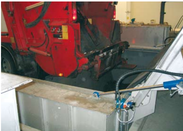
Einfüllen von Haushaltsabfall in eine der bereits installierten Aufnahmestationen.
