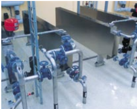
Zwei Wärmetauscheinheiten Schlamm/Schlamm in der Kläranlage Vimmerby
